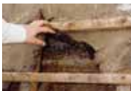
Disminución, hasta la pérdida, de la eficiencia del aislamiento
